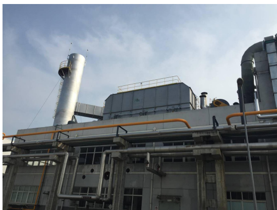
RTO(蓄热式氧化炉)
